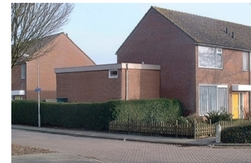
Zijaanbouw te hoog.
