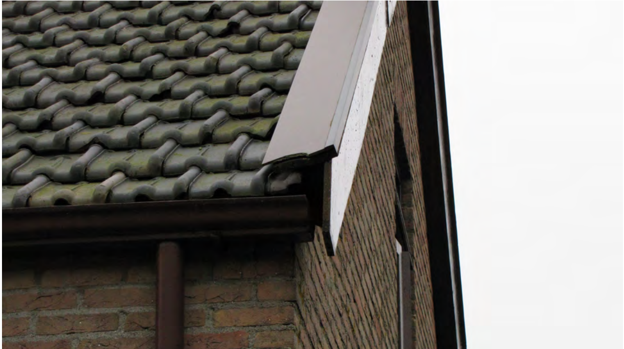
Figuur 5: Oostelijk gelegen woning met losse dakpannen en houten betimmering
