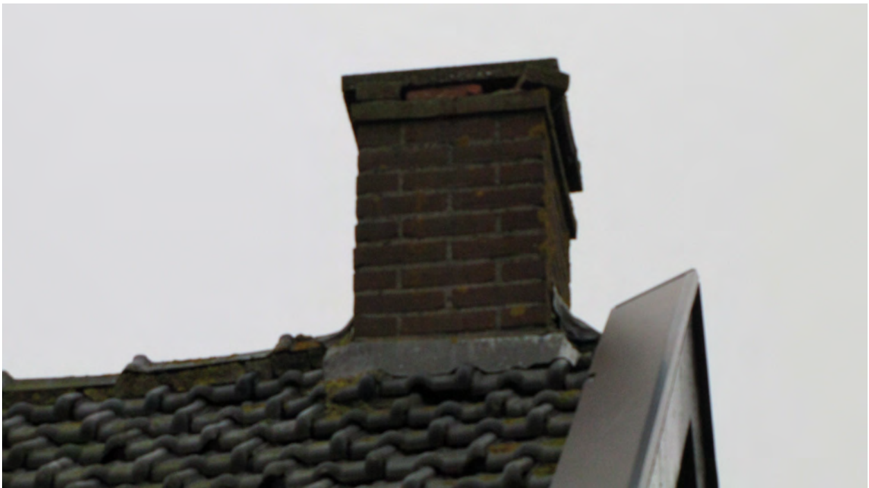
Figuur 6: Schoorsteen met spleten en loden plaatjes van de oostelijk gelegen woning
