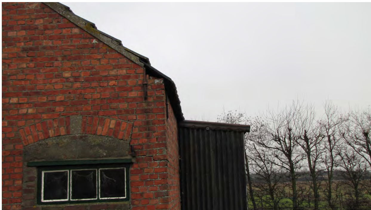
Figuur 7: Een van de schuren die zich op het erf bevinden, bij de dakrand is een opening te zien
