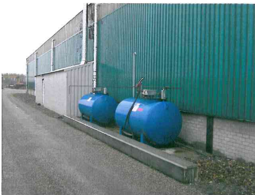
Foto IMG_2361, Verdachte deellocatie 14. Twee dubbelwandige brandstoftanks gezien in zuid zuidwestelijke richting. Het gebouw achter de tanks betreft een deel van de loods van verdachte deellocatie 8. Fabricagehal heipalen.
