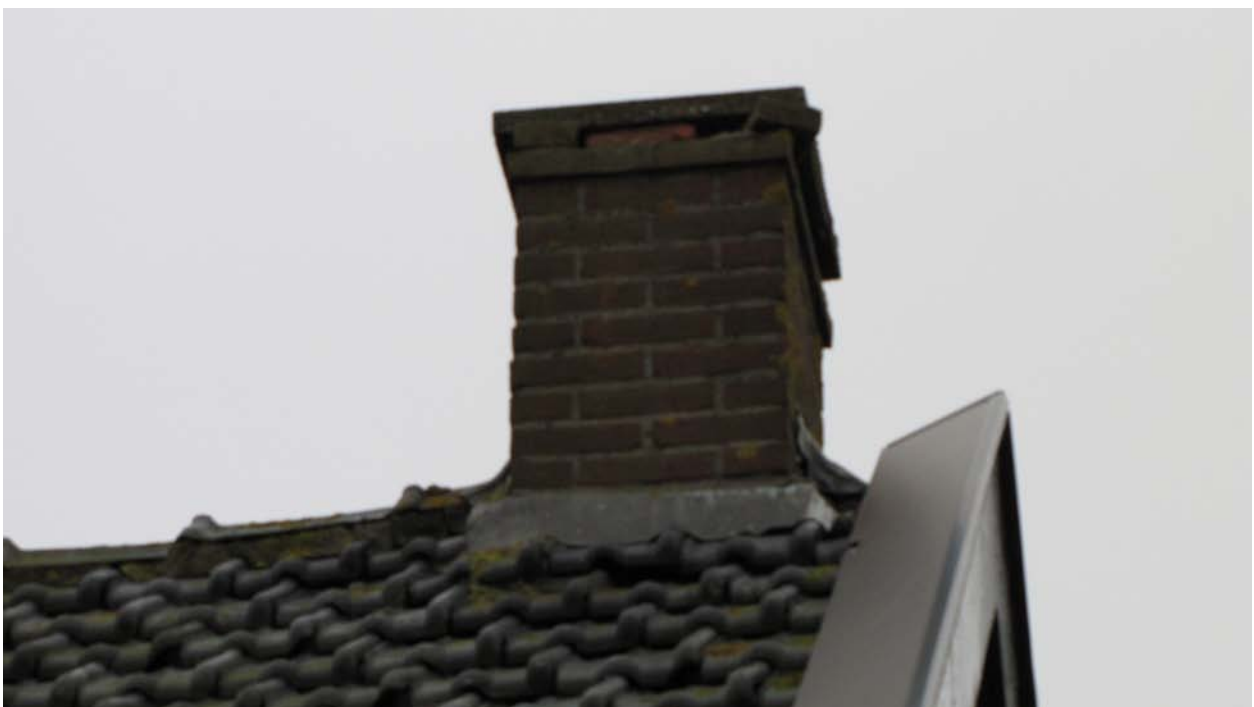
Figuur 6: Schoorsteen met spleten en loden plaatjes van de oostelijk gelegen woning
