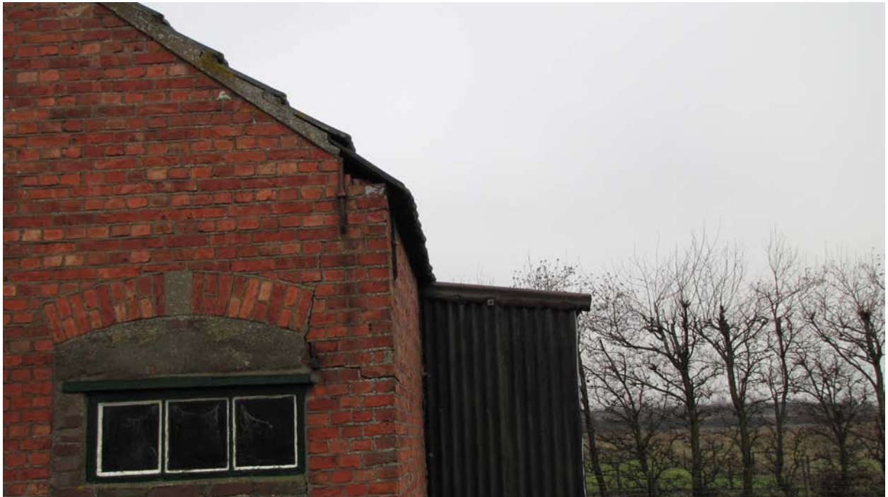
Figuur 7: Een van de schuren die zich op het erf bevinden, bij de dakrand is een opening te zien
