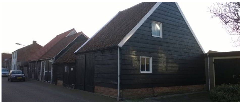
vervallen locaties historische dorpskern, met onder een reeds opgeknapte locatie
