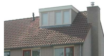
Te hoog op het dak, profiel van de woning wordt aange- stast.
