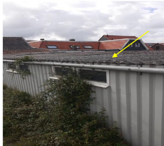
Foto 4: Het dak met asbestverdachte golfplaten (gele pijl) van de aangebouwde schuur.
